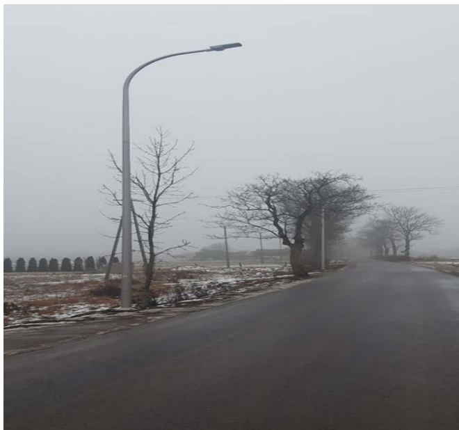
Oświetlenie drogowe w Dąbrowie
